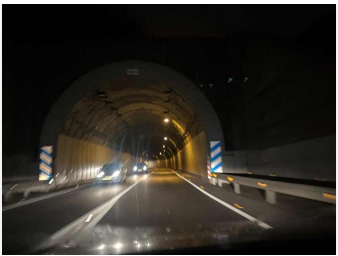
L2-CM12-01-F01 · Túnel de San Vicente: tramos oscuros, refuerzo sin encender · GPS 28.392688, -16.591252
