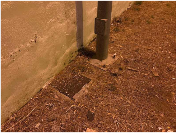
L2-A11-F15 · Base de columna: pernos de anclaje sin caperuzas con oxidación incipiente; arqueta con tapa presente y asentada · GPS 28.395090, -16.551918
