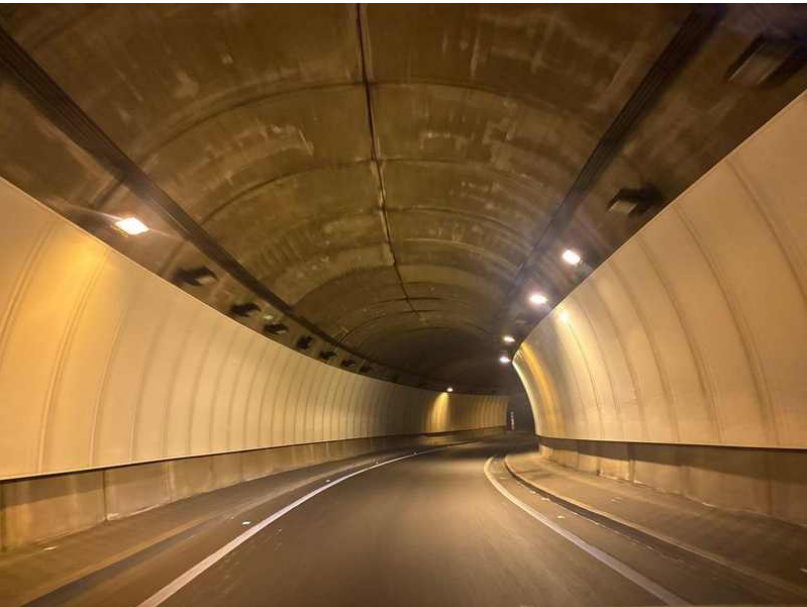
L2-A05·F01 · Proyectores encendidos de tono cálido en el arranque de bóveda de túnel del corredor (toma nocturna en marcha); cobertura de la pasarela Guajara a completar en la línea base · GPS 28.464673, -16.304509
