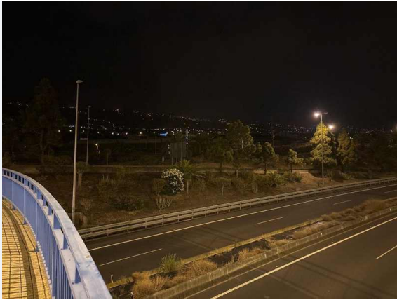
L2-A11-F11 · Punto de luz apagado en primer término dentro de secuencia encendida; banda de calzada en penumbra aparente · GPS 28.394921, -16.551772
