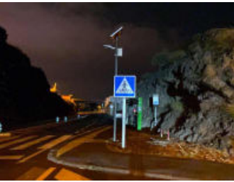
L2-P02-F02 · Paso TF-320: conjunto solar apagado en horario nocturno · GPS 28.397047, -16.562627
