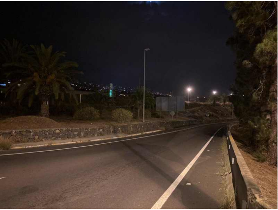
L2-A11-F14 · Luminaria apagada en el centro de la escena; iluminación discontinua en la secuencia visual · GPS 28.394666, -16.551482
