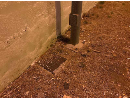
Pernos de anclaje sin caperuzas con oxidación incipiente en base de columna del corredor TF-5 · L2-A11-F15
