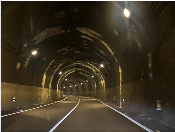
L2-A13-F01 · Túnel de Santo Domingo: proyectores de hastial encendidos con tramos de penumbra entre puntos; cableado grapado visto (toma en marcha) · GPS 28.388538, -16.671531
