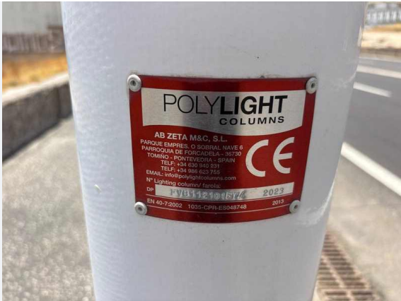
L2-A15-F22 · Placa de identificación Polylight (EN 40-7, año 2023) en fuste: columna de material compuesto coherente con el inventario · GPS 28.494844, -16.215170
