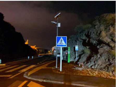
Conjunto solar del paso TF-320 (panel, luminaria y caja de batería) apagado en horario nocturno — hallazgo P1, reposición ≤30 días · L2-P02-F02
