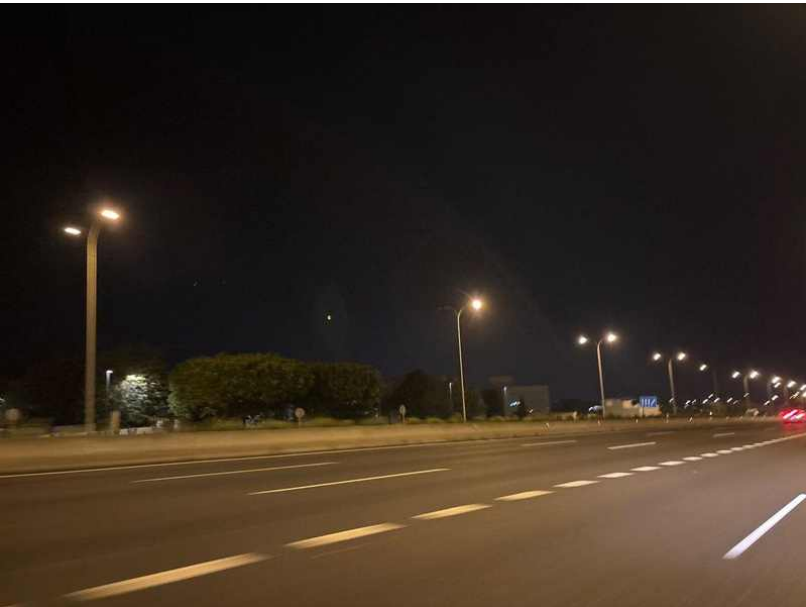
L2-A10·F09 · Tronco TF-5: luminaria de margen y alineación de mediana con brazo encendidas, sin puntos apagados en el plano (toma nocturna en marcha) · GPS 28.469583, -16.307097
