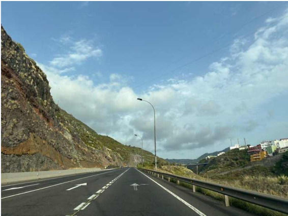
L2-A17-F02 · Variante de Tejina: báculos de brazo curvo con luminaria vial cerrada; ensuciamiento del galvanizado en la mitad inferior del fuste · GPS 28.534774, -16.357680
