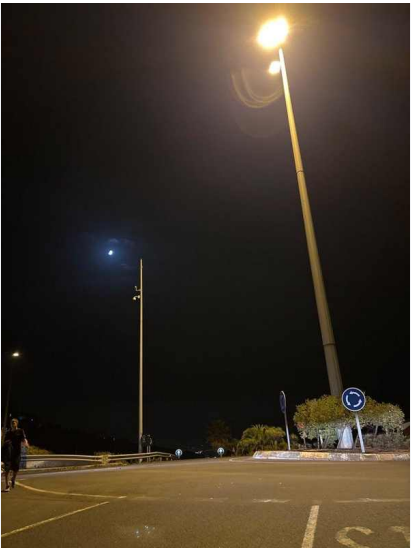
L2-A10-F06 · Columna troncocónica de gran altura con junta de fuste y equipo auxiliar bajo la luminaria principal; anillo de la glorieta en penumbra · GPS 28.459693, -16.449095
