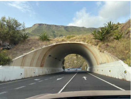
Bóveda del falso túnel de la Variante de Tejina con escorrentías de tinción ferruginosa junto a los proyectores · L2-A17-F01
