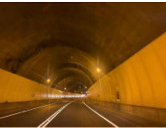
L2-CM20-01-F02 · Túnel de Las Aguas: mayoría de luminarias apagadas · GPS 28.372265, -16.741184
