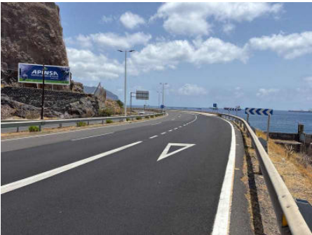
Columna de mediana con cruceta y dos luminarias de óptica plana tipo LED, coherentes con las DENIA 2 del inventario · TF-11 · L2-A15-F07
