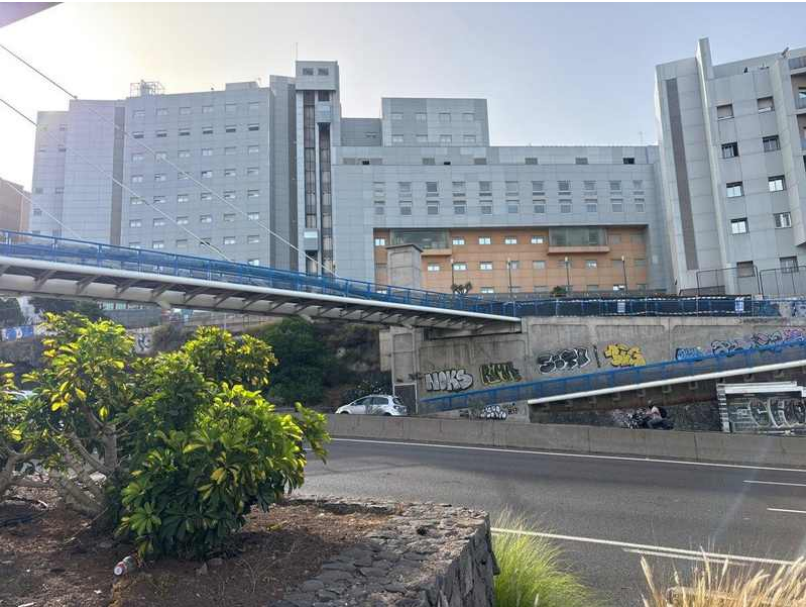
L2-A01·F02 · Cerramiento provisional de obra sobre la rampa de acceso a la pasarela; grafitis extensos en muros de contención · GPS 28.447600, -16.283693
