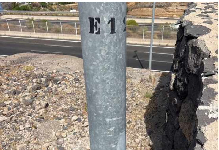
A03-F07 · Rotulado de fuste «CM.../E1...», galvanizado en buen estado · GPS 28.360164, -16.372217
