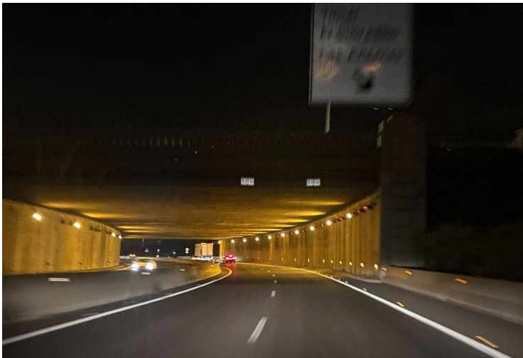
A09-F01 · Paso inferior TF-2: alumbrado interior encendido, tono cálido · GPS 28.446522, -16.308488
