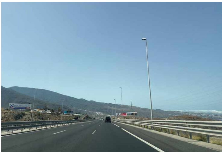
A03-F05 · Tronco TF-1: columnas galvanizadas 12-14 m, luminaria vial cerrada · GPS 28.345280, -16.373653
