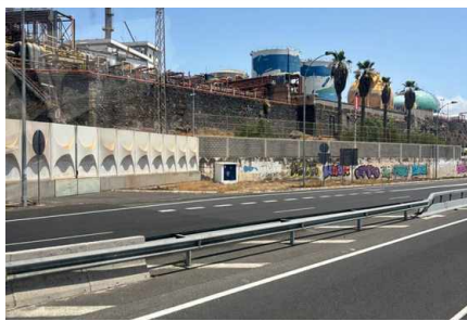
Armario TF-4 · penetración · envoltorio con grafitis y sin rotulación legible · L1-CM10-01-F01 · GPS 28.448079, -16.269836
