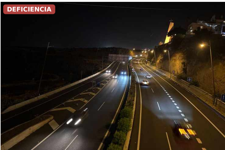
A08-F29 · Tronco TF-1: margen derecha encendida, amplias zonas oscuras opuestas · GPS 28.106847, -16.732145
