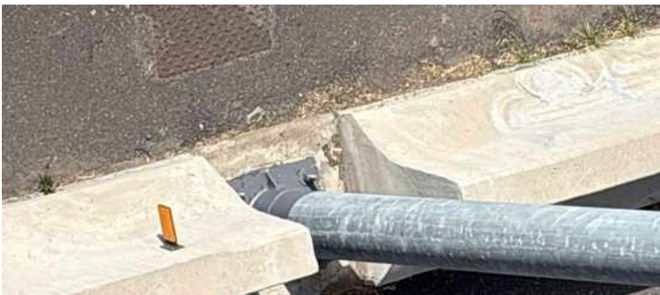
A03-F08 · Columna tumbada fuera de servicio junto a calzada — reparación urgente 24h · GPS 28.360099, -16.372014
