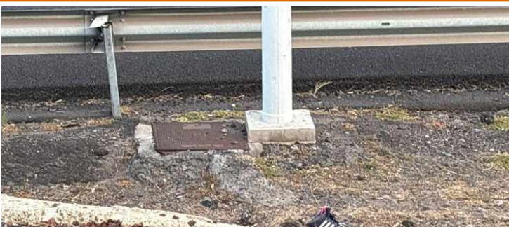
A06-F03 · Cimentación vista sin rematar y arqueta con tapa oxidada — remate de obra civil · GPS 28.058661, -16.581536
