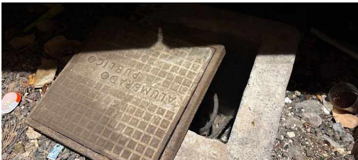
A08-F21 · Arqueta de alumbrado abierta con tapa desencajada y conductores visibles — reposición de tapa · GPS 28.092693, -16.729895
