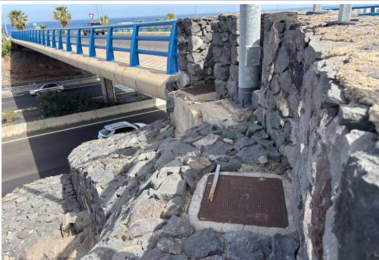
A03-F15 · Base sobre murete y arqueta «ALUMBRADO» con tapa presente · GPS 28.370996, -16.367827
