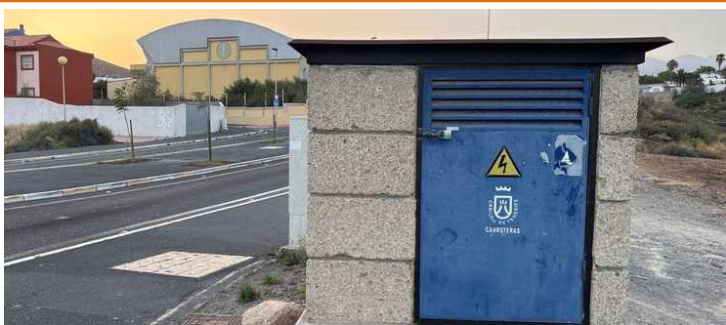
A05-F10 · Envoltente del centro de mando con deterioro superficial — limpieza/repintado · GPS 28.068677, -16.562411
