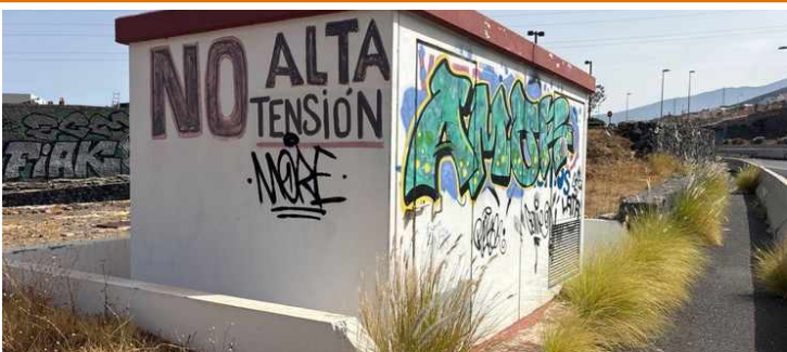
A03-F25 · Vandalismo extenso por grafitis en caseta de instalaciones — limpieza/repintado · GPS 28.383589, -16.361714
