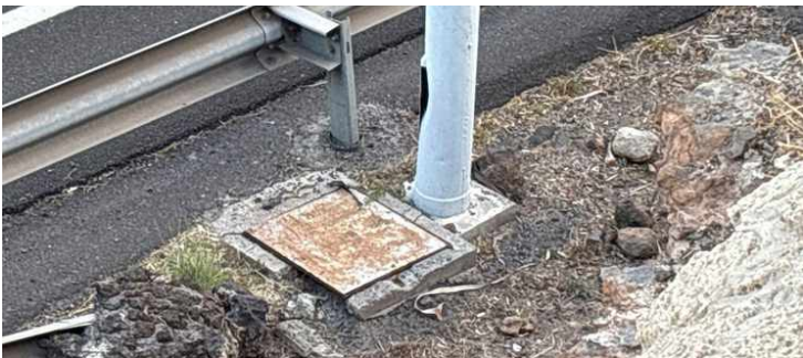
CM06-01-F01 · Arqueta de alumbrado con tapa corroída y marco deteriorado — reposición de tapa · GPS 28.058892, -16.580977
