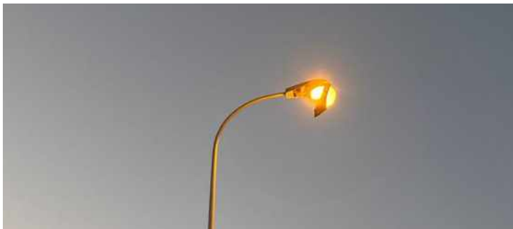
CM06-01-F12 · Luminaria en servicio con carcasa abierta y elemento colgando — reparación urgente 24h · GPS 28.059175, -16.580983
