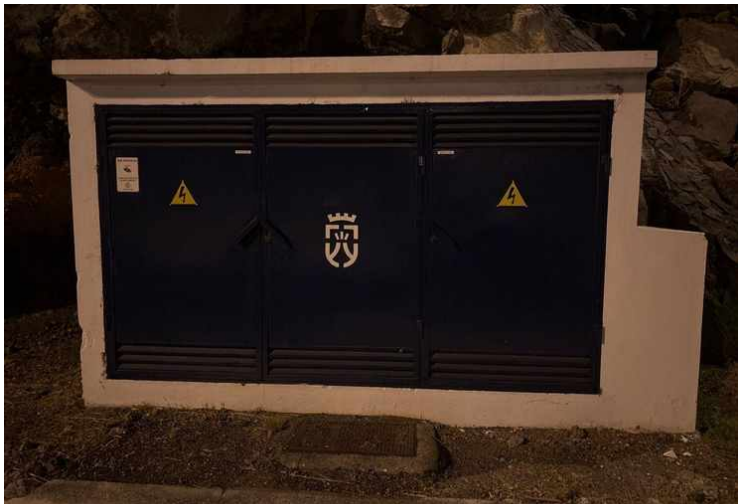
A09-F04 · Cuadro de mando encastrado en murete, puertas íntegras · GPS 28.426341, -16.304074
