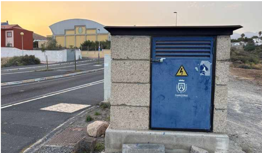
Envolvente de centro de mando con deterioro superficial (ámbito con enganche a cuadro municipal) · L1-A05-F10 · 28.068677, -16.562411
