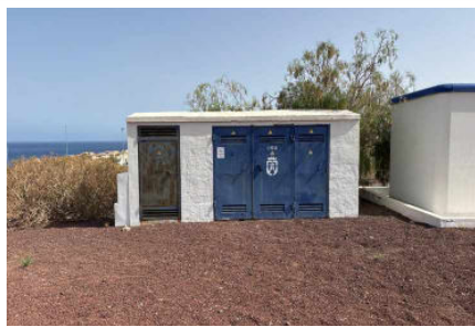
Caseta CM 8 · TF-1 SC-Arafo · rotulación «CM 8» legible, puertas metálicas con corrosión superficial · L1-A03-F20 · GPS 28.370760, -16.368035
