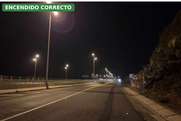
A09-F06 · TF-2 en tramo abierto: ambas márgenes encendidas, sin apagados · GPS 28.426330, -16.304075
