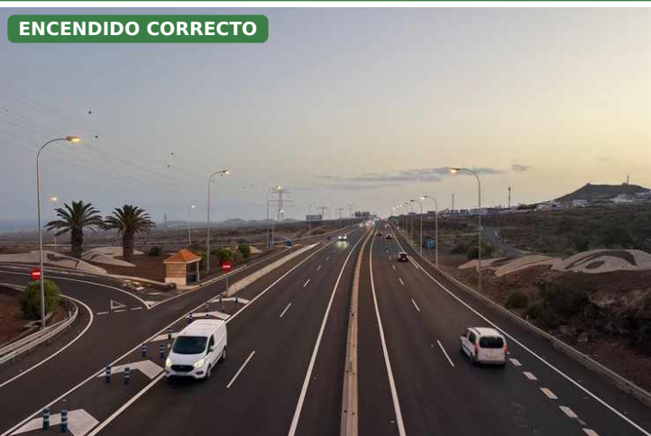
A06-F06 · 21:16 local: encendido ámbar homogéneo en enlace del aeropuerto · GPS 28.058733, -16.580786
