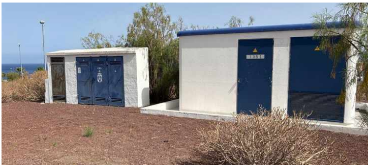
A03-F22 · Corrosión severa en puerta de caseta CM-8 — limpieza/repintado · GPS 28.370756, -16.368123
