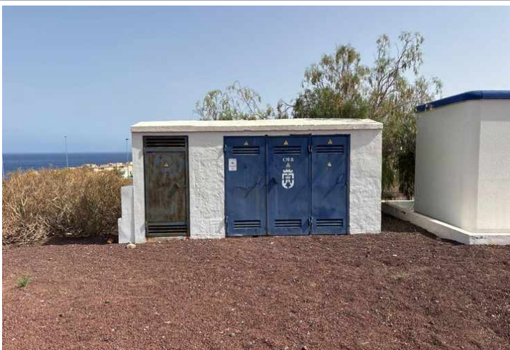
A03-F20 · Cuadro CM 8 en caseta encalada, puertas metálicas cerradas · GPS 28.370760, -16.368035
