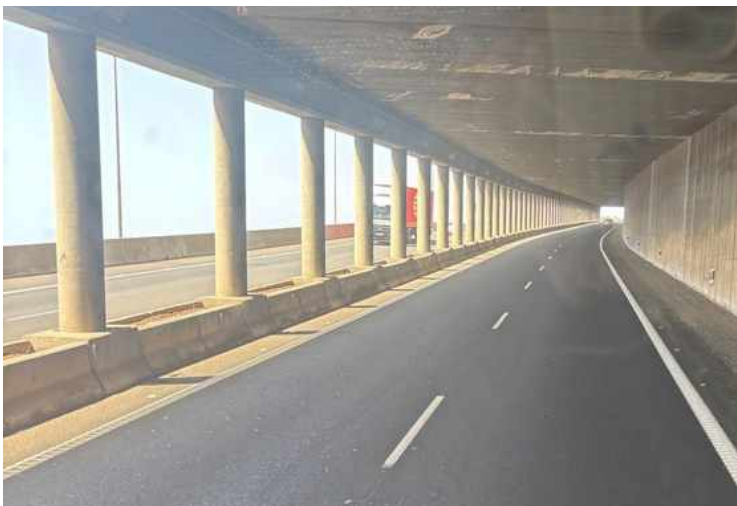
CT03-F03 · Interior del túnel: equipos adosados, apagados a luz diurna · GPS 28.425077, -16.304366
