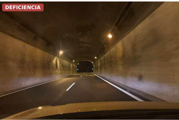
A03-F61 · Túnel: baja densidad de puntos encendidos en tramo central · GPS 28.281110, -16.385056
