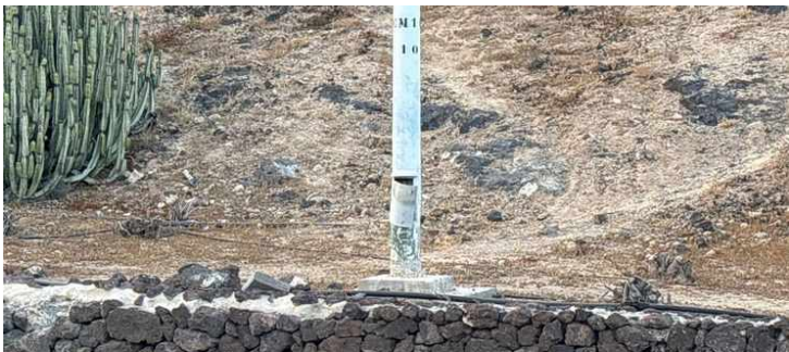
CM06-01-F04 · Portezuela de registro de columna desprendida — reposición de portezuela · GPS 28.059673, -16.579749
