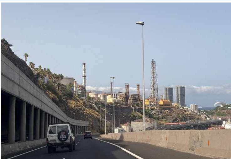
A10-F01 · Columna de mediana con luminaria plana tipo LED · GPS 28.447325, -16.270396
