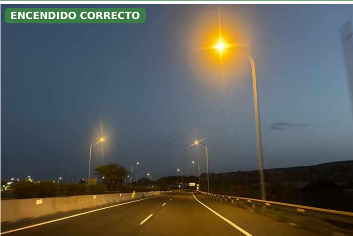
CM07-01-F02 · 21:28 local: secuencia VSAP encendida sin huecos oscuros · GPS 28.047251, -16.679863
