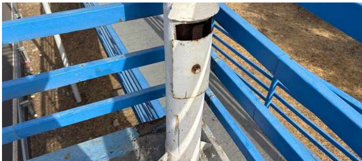
A03-F43 · Portezuela de registro deteriorada y semiabierta en columna de pasarela — reposición de portezuela · GPS 28.446506, -16.289520
