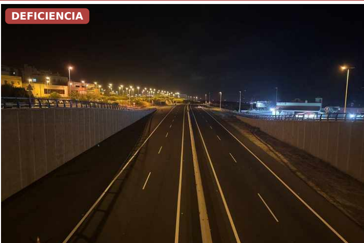
A05-F03 · Tronco en trinchera sin puntos encendidos; enlace superior iluminado · GPS 28.070736, -16.554749
