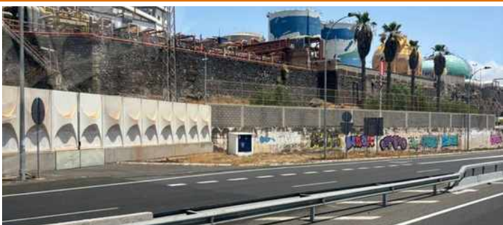
CM10-01-F01 · Grafitis sobre armario de la instalación — limpieza/repintado · GPS 28.448079, -16.269836
