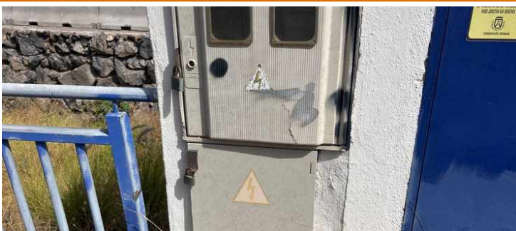
A03-F24 · Envoltente de módulo de contadores fisurada y vandalizada — sustitución de envoltente · GPS 28.383796, -16.361456
