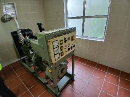
Grupo existente de arranque manual (foto 01/07/2026): sustitución uno a uno con socorro provisional disponible
