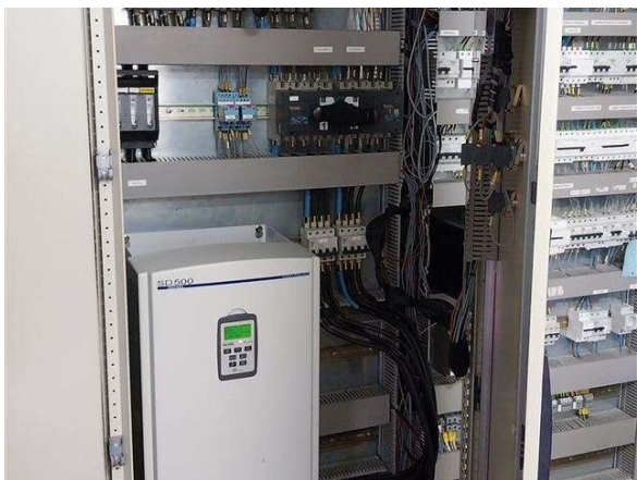
F15. Cuadro renovado parcialmente (variador): instalación estratificada
