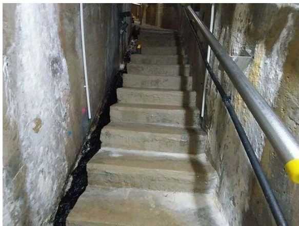
F04. Escalera de galería: eflorescencias calcáreas y servicios grapados
