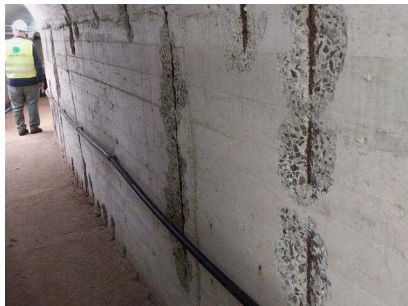
F03. Galería: armaduras vistas con corrosión activa en bóveda
