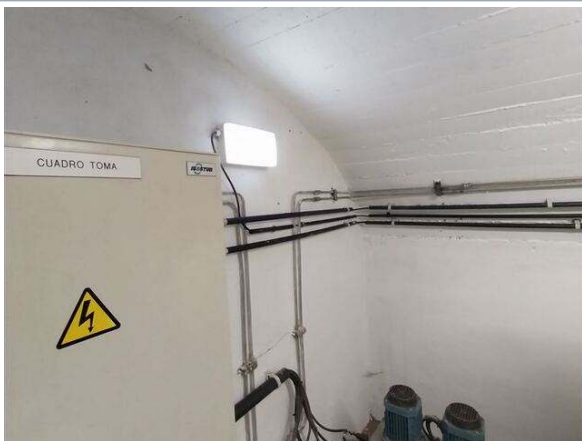
F07. Cámara de válvulas: central oleohidráulica y cuadro de la toma
