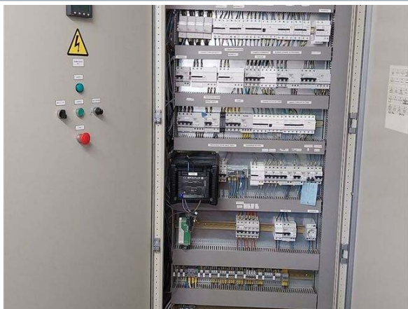
F09. Cuadros eléctricos existentes: apartamenta de varias épocas
