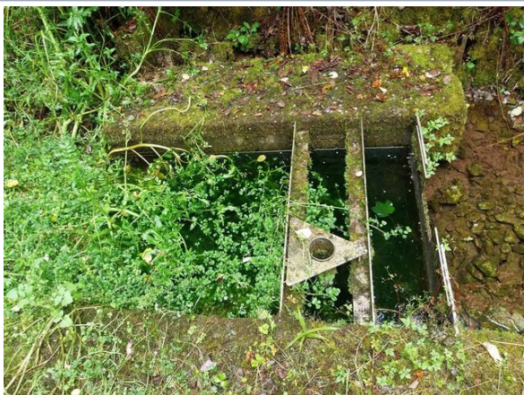
F10. Aforador a pie de presa anegado y colonizado por vegetación
