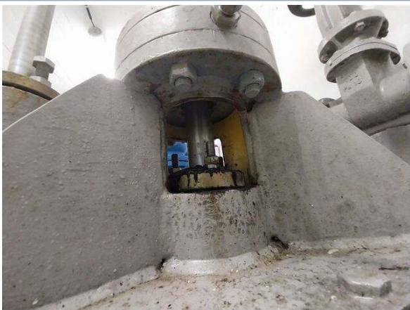
F06. Cilindro oleohidráulico de compuerta de la toma (fuga por retenes)
