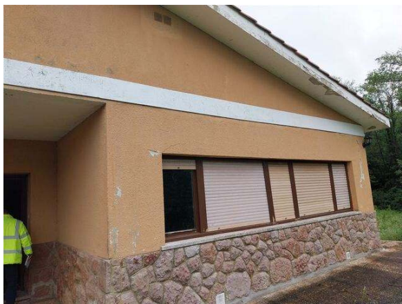
F14. Casa de Administración: desconchones y humedades en fachada
