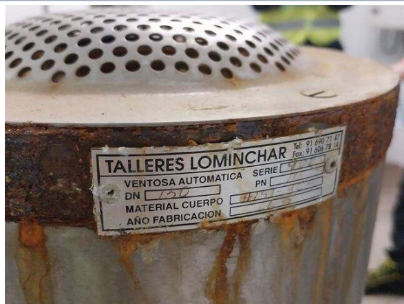
F08. Ventosa antigua (Talleres Lominchar) con corrosión avanzada
