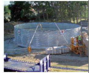
Planta de lodos.
